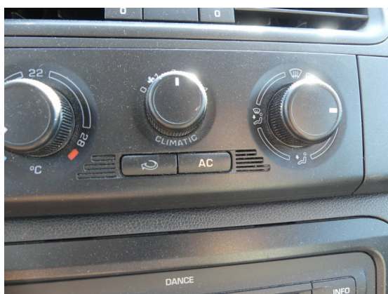
Bild 27: Technik / Klimaanlage Kühlt nicht
