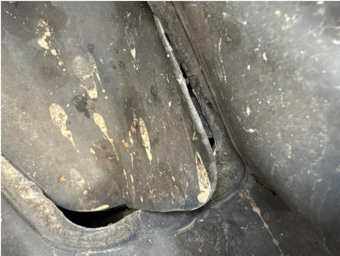
7. Radhausschale vorne rechts - Gerissen
